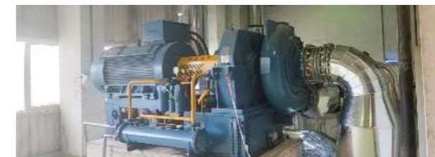
真空系统改造项目
