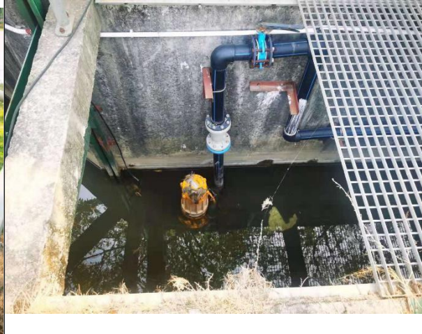
雨水沟闸门应急提升泵
