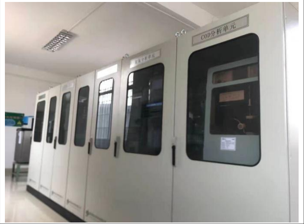
污水在线监控室
