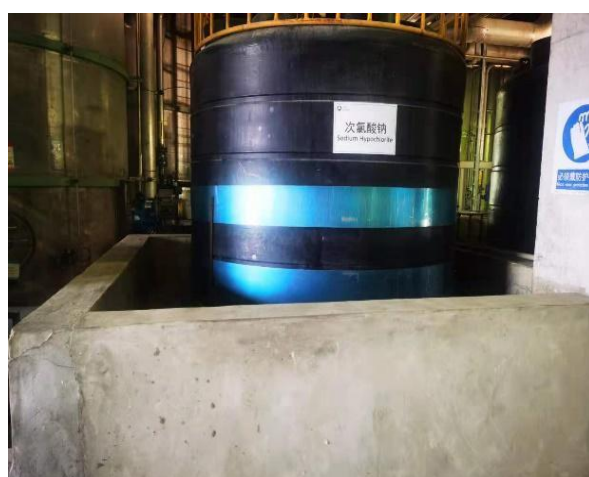
次氯酸钠罐围堰
