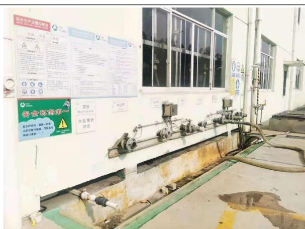
化学卸料防泄漏槽
