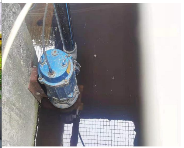
雨水沟闸门应急提升泵
