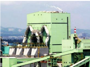
碱炉脱硝系统
