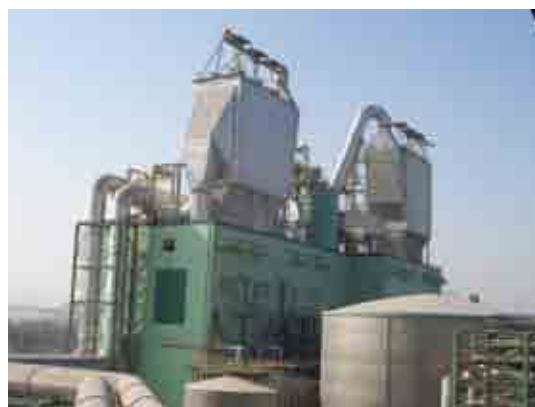
照片 4 二期石灰窑静电除尘器
