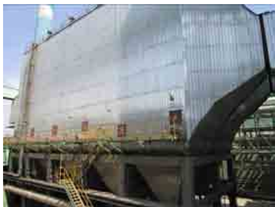
照片 5 动力锅炉双室 5 电场静电除尘器
