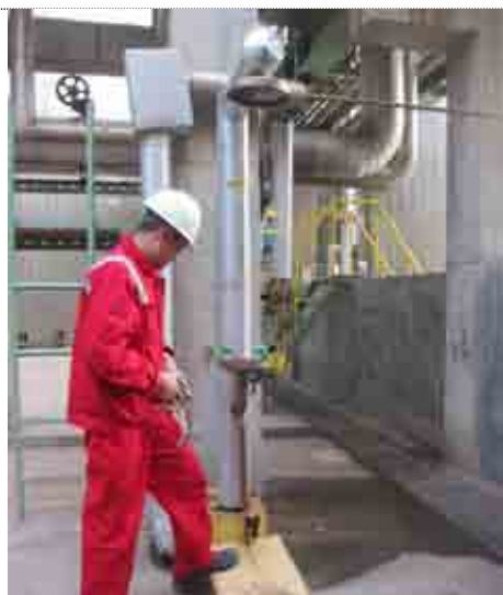
照片 9 化工原料储备区洗眼器
