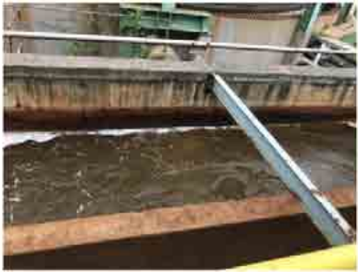
照片 10 污水场出水总排口
