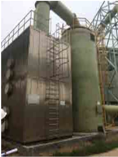
照片 8 污水处理场生物除臭设施
