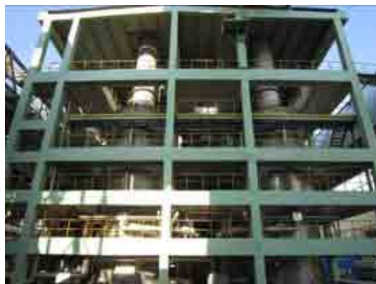
照片 6 臭气焚烧炉
