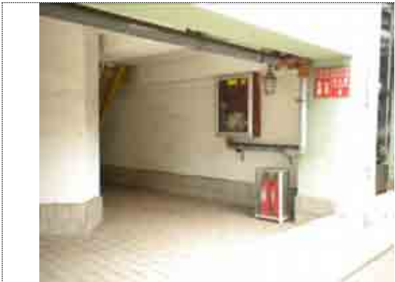
照片 1 化学品车间消防栓和灭火器
